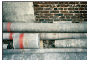
© INRS Canalisation en amiante
